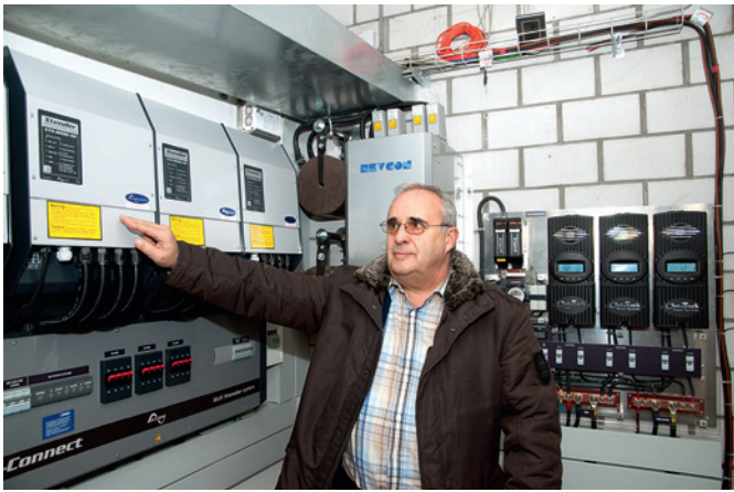
Dieter Zeffass in der Hauszentrale; hier wird die aktuelle Stromerzeugung (BHKW, Solaranlage) sowie der Strombezug abgelesen.
