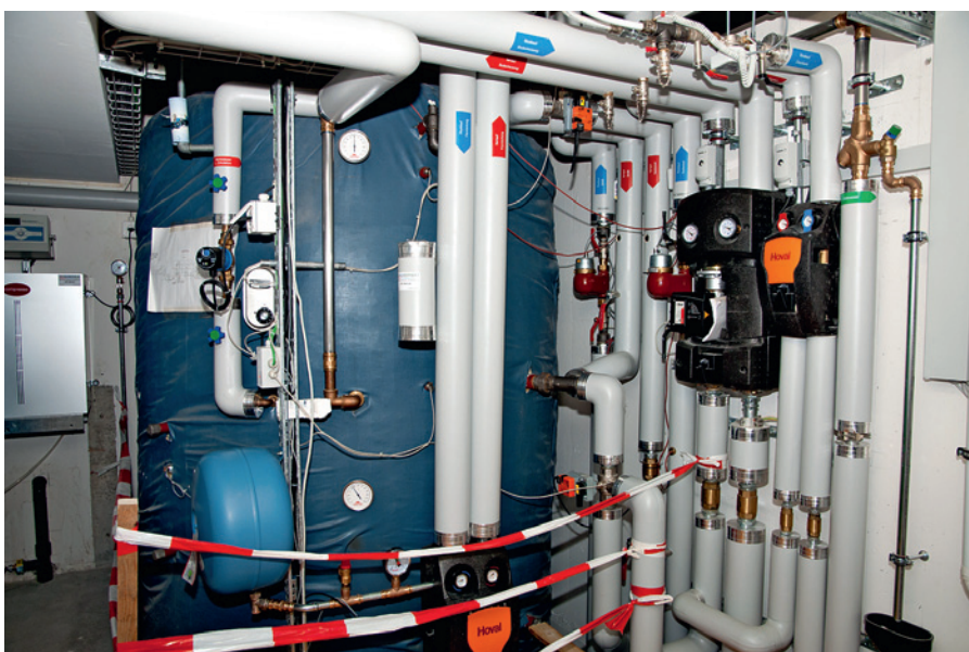
Der 7000-Liter-Warmwasserspeicher; die Wärme stammt vom BHKW, das 1/3 Strom und 2/3 Wärme erzeugt.
