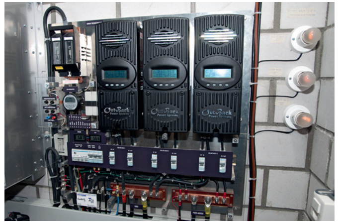
Kernstück der Hauszentrale: Laderegler der PV-Anlage (5,8 kWp) und die 3-Phasen-Wechselrichter (126 KVA max.).
